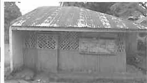
老朽化した校舎
